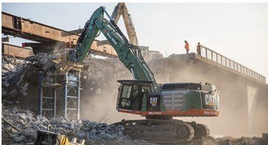
Die Brücke bei Ismaning wurde über eine Stahlkonstruktion abgehängt und für den Untergrund erschütterungsarm abgebrochen
