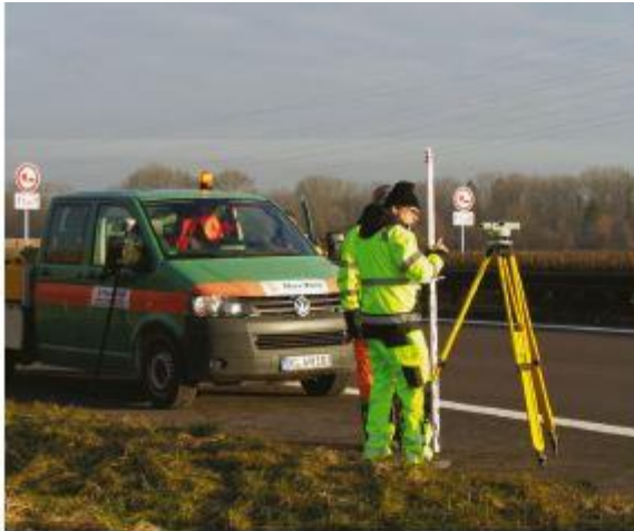
Damit es bei den Bauarbeiten unter der Autobahn A 7 keine bösen Überraschungen gibt, werden im Vorfeld Georadaruntersuchungen durchgeführt.
