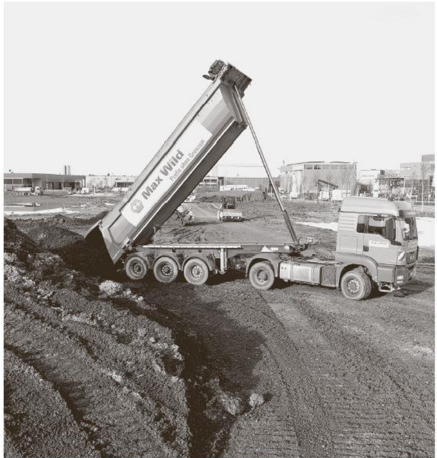
Im Rahmen des Projekts gilt es insgesamt bis zu 30 000 t Humus abzutragen und abzufahren und ca. 120 000 t Auffüllmaterial anzuliefern und einzubauen. FOTO: MAX WILD
