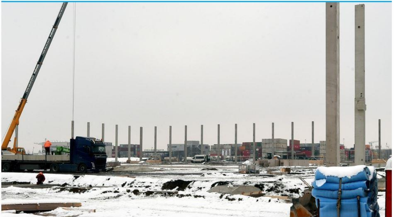
Im Güterverkehrszentrum im Grenzgebiet von Aunshorn, Gersthofen und Neusäß entsteht eine neue Logistikhalle. Mitte des
